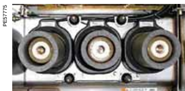
Трансформаторы тока на проходных изоляторах
